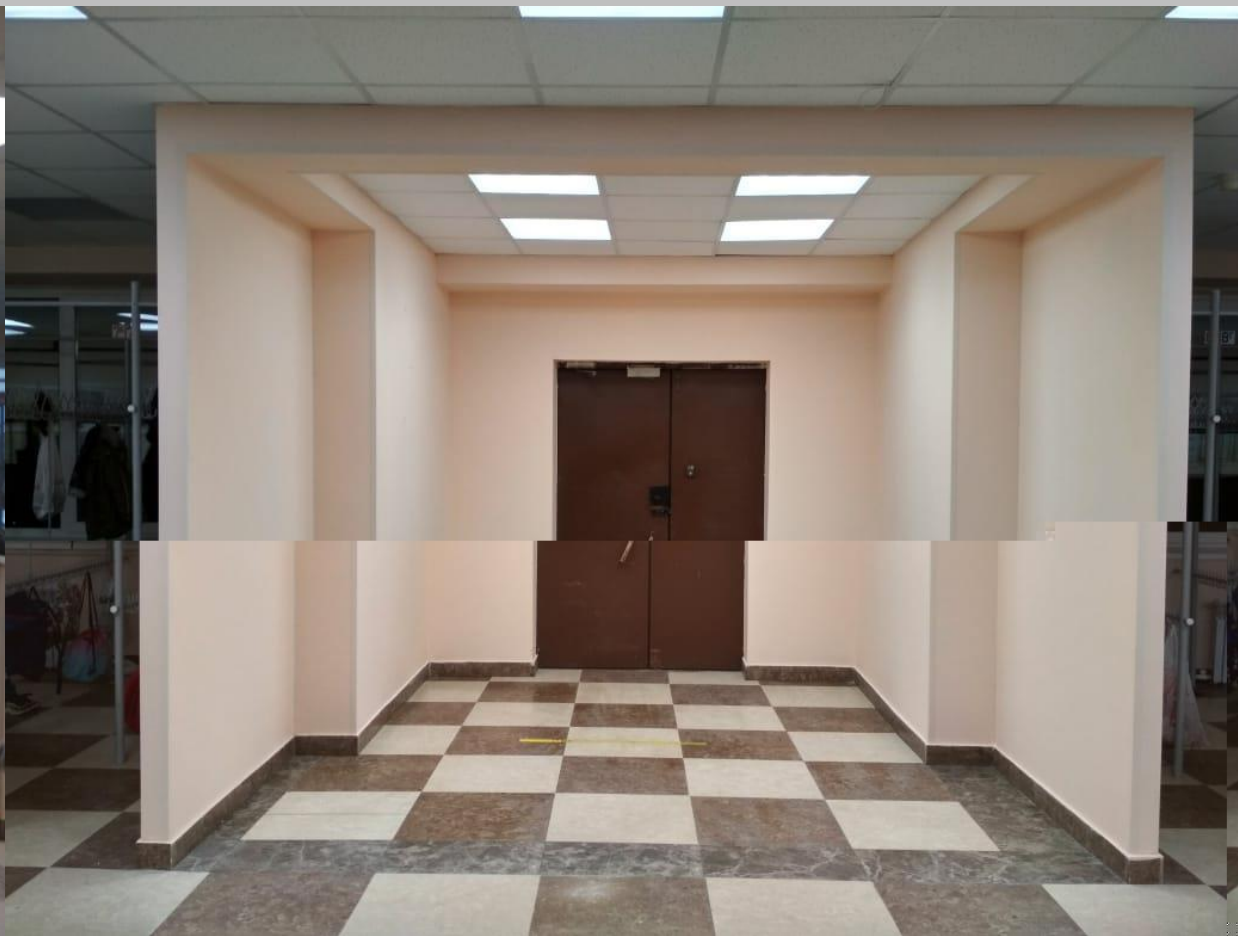
Подготовленное пространство по установке системы контроля доступа
